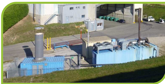
Moteur de cogénération et torchère
