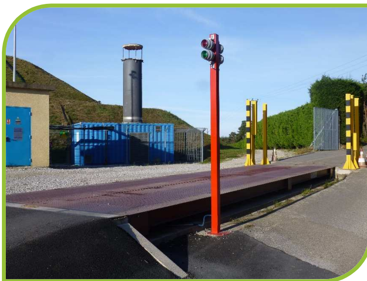
Nouveau pont de pesée de l'ISDND
